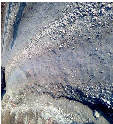
Foto nr. 13: Reparația necalitativă a drumului din s. Bașcalia
