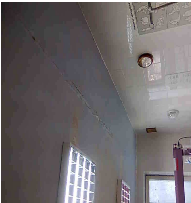
Foto nr. 12: Tencuială căzută de pe tavanul Secției maternitate a Spitalului raional Basarabeasca
